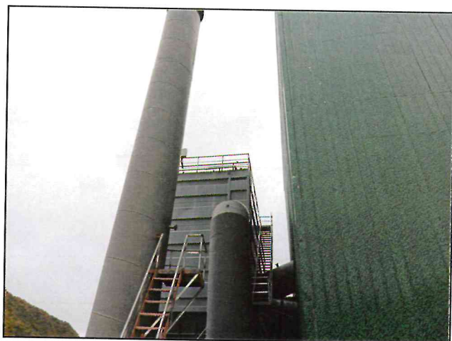
二级筛分车间除尘系统
