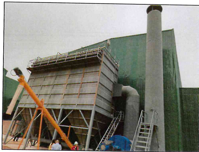
一级筛分车间除尘系统
