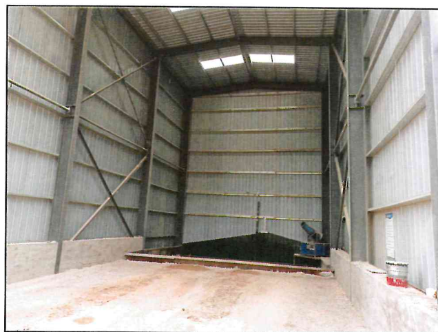
石料生产加工系统一级破碎进料口
